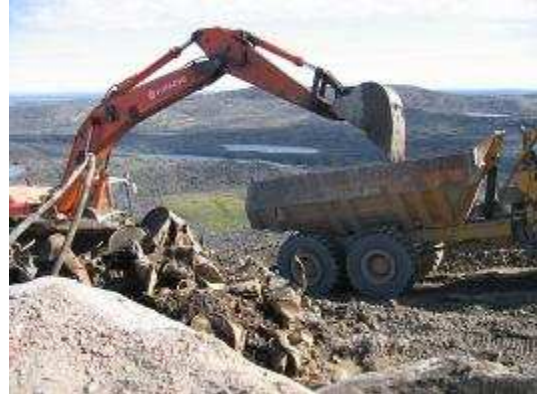
Excavation d'anciens sites d'enfouissement de déchets Excavation d'anciens sites d'enfouissement de déchets
